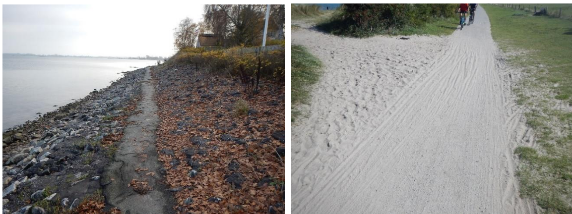
Abbildung 16: Beispiele identifizierter Mängelstrecken des Ostseeküstenradwegs. Links ein unbefahrbarer, sehr schmaler Weg direkt an der Wasserlinie (Kreis Schleswig-Flensburg). Rechts ein schlecht befahrbarer Abschnitt mit sehr sandigem Bode auf Fehmarn. Eigene Aufnahmen.
