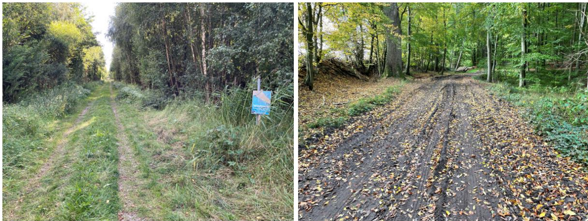
Abbildung 12: Beispielbilder von Wegen mit der Belagsqualität „unbefahrbar“. Eigene Aufnahmen.
