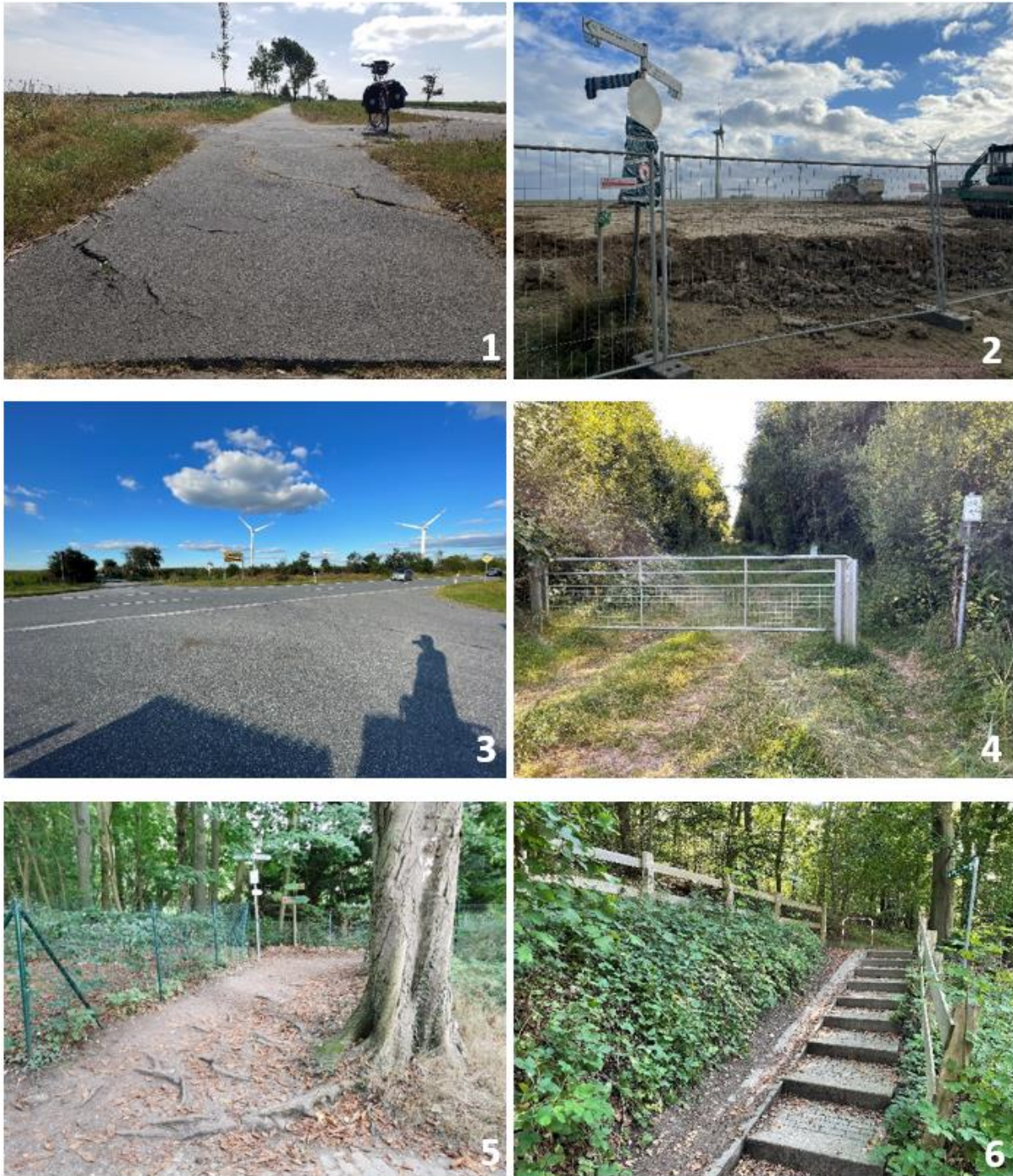
Abbildung 18: Bildercollage von im Rahmen der Befahrung aufgenommenen punktuellen Mängeln. Bild 1: Schwere Belagsschäden auf straßenbegleitendem Radweg bei Welt, Wikinger-Friesen-Weg. Bild 2: Radwegweiser weisen auf abgesperrtes Großbaustellengelände bei Puttgarden, Mönchsweg. Bild 3: Sehr gefährliche ungesicherte Querung der vielbefahrenen L 192 bei Weesby, Grenzroute. Bild 4: Unmarkiertes Gatter mit extrem schmalen Durchgang bei Aventoft, Grenzroute. Bild 5: Ausgeprägte Wurzeln im Weg bei Krummsee, Holsteinische Schweiz Radtour. Bild 6: Treppe mit sehr schmaler Rampe für Radfahrende und Umlaufschranke bei Bosau, Mönchsweg. Eigene Darstellung und Aufnahmen.
