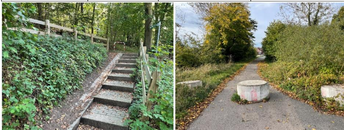
Abbildung 30: Beispiele identifizierter punktueller Mängel der Holsteinischen Schweiz Radtour. Links eine Treppe mit unbefahrbarer Rampe und Umlaufschranke. Rechts ein sehr schlecht markierter Betonpoller mit zu geringer Durchfahrtsbreite. Eigene Aufnahmen.
